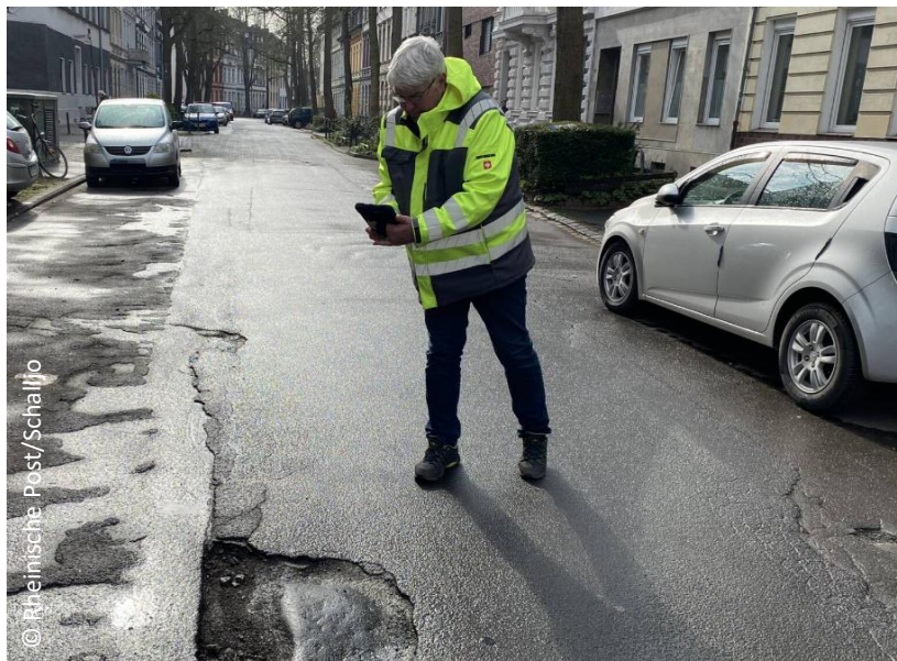
Straßenbegeher beurteilen und dokumentieren die Schäden
