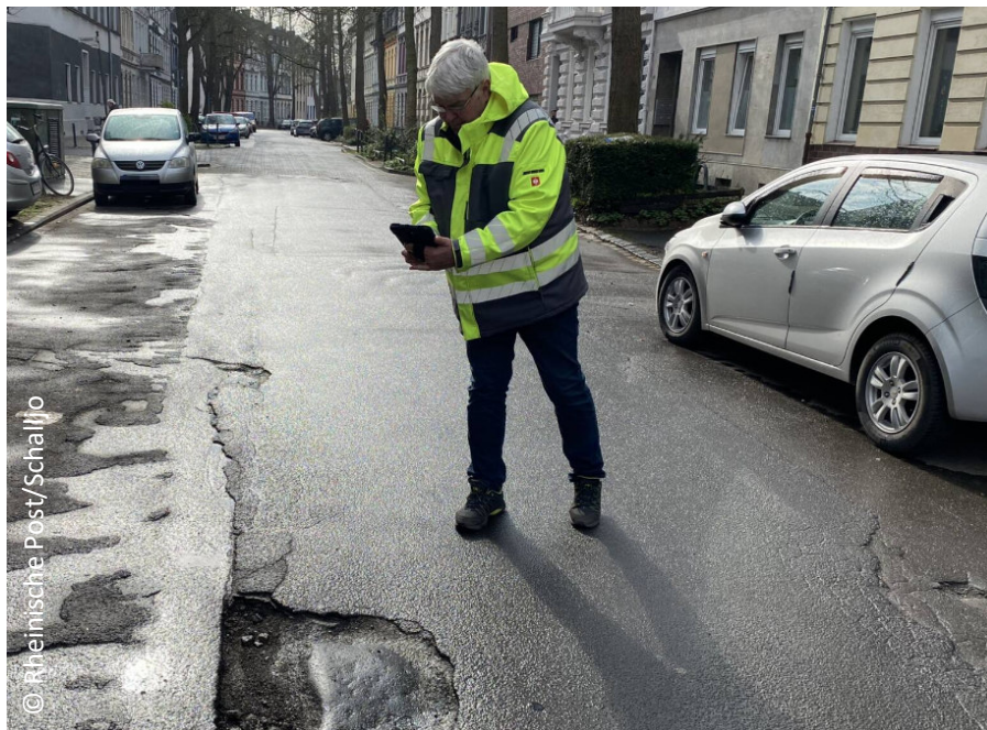
Straßenbegeher beurteilen und dokumentieren die Schäden
